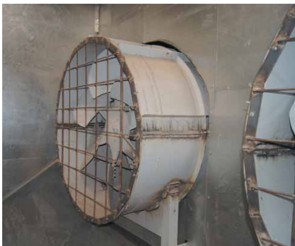
Рис. 2. Два параллельно подключенных вентилятора дымоудаления из зрительного зала
